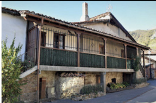
Fachada norte (detalle galería cerrada inadecuadamente con rejería metálica)
